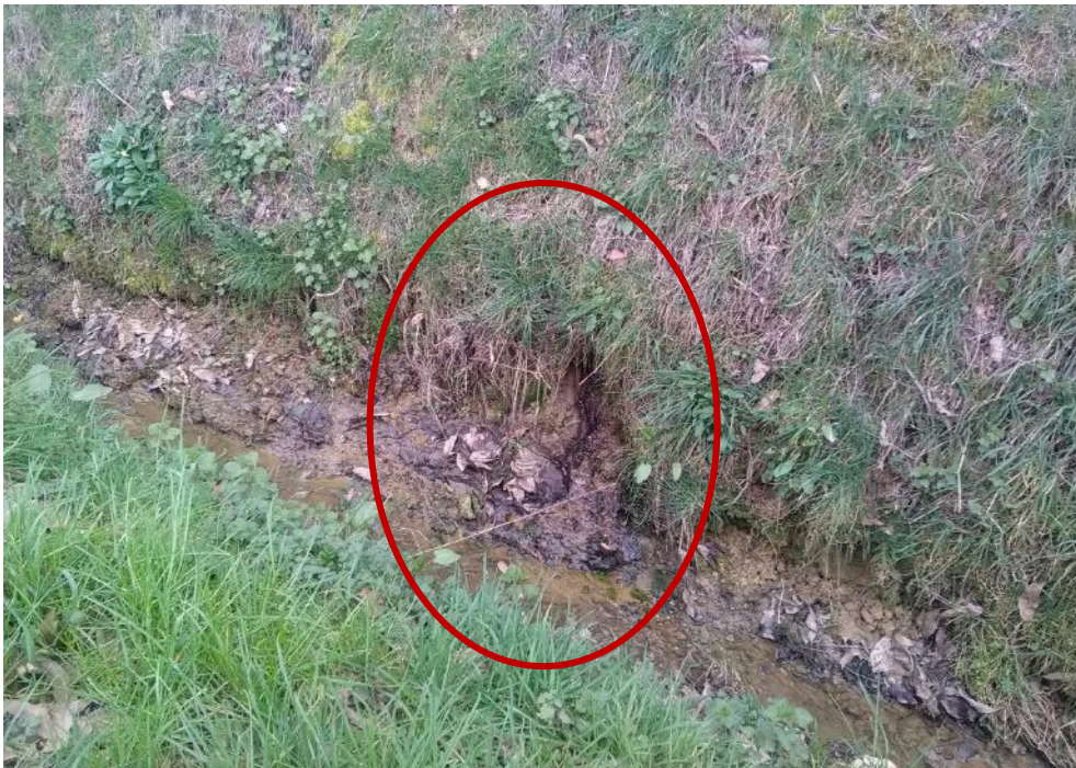
Figure 26 : Rejet de fosse à lisier avéré (Couesnon, Mars 2019)
